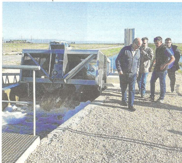
Imatge d'una de les dos bombes instal·lades recentment al Canal del Penal, a Deltebre. FOTO: JOAN REVILLAS
