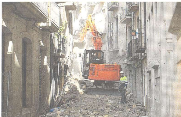
Mentrestant els treballs de desenrunament segueixen a l'espai on van ensorrar-se dues cases al carrer Montcada. FOTO: JOAN REVILLAS
