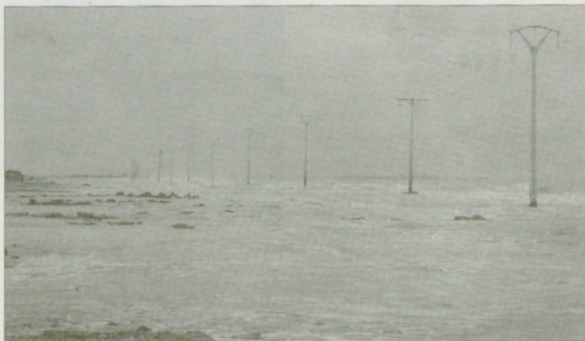
En els temporals la línia elèctrica queda dins l'aigua.
