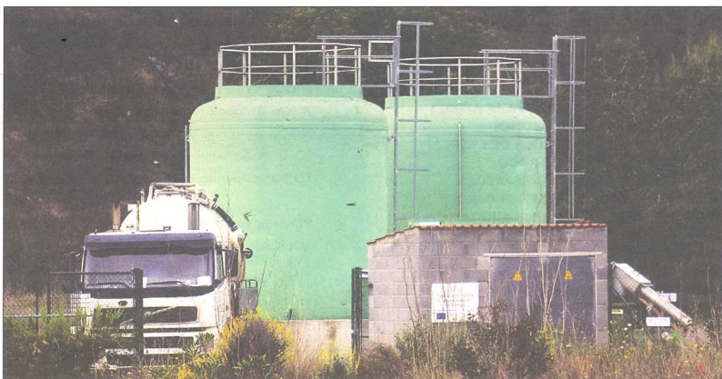
Un camió fa diversos viatges cada dia entre la depuradora de Tivenys, a la imatge, i la de Tortosa-Roquetes. / N. CARO
