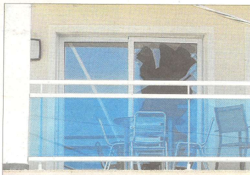
Un vidre trencat d'un xalet de l'entorn a la zona de l'explosió, ahir al migdia. FOTO: JOAN REVILLAS
