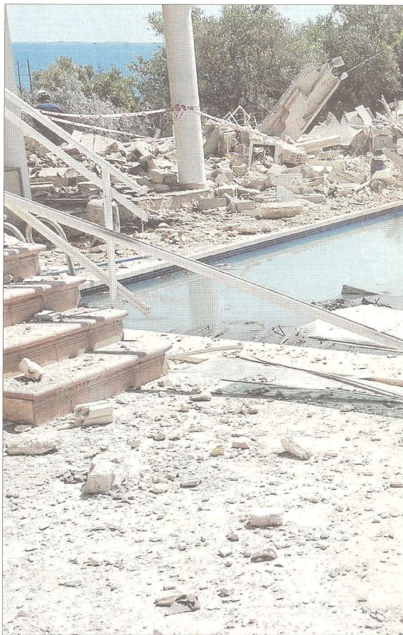
Molta runa de l'habitatge sinistrat es va projectar al xalet ubicat al seu costat. FOTO: ACN
