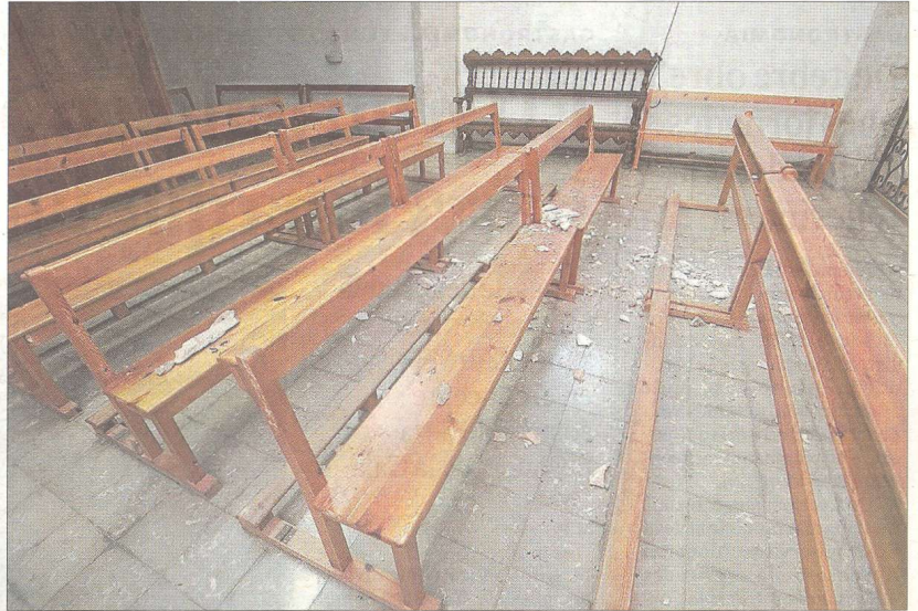
Imatge dels trossos de sostre que han caigut sobre els bancs de l'església del convent. FOTO: JOAN REVILLAS
