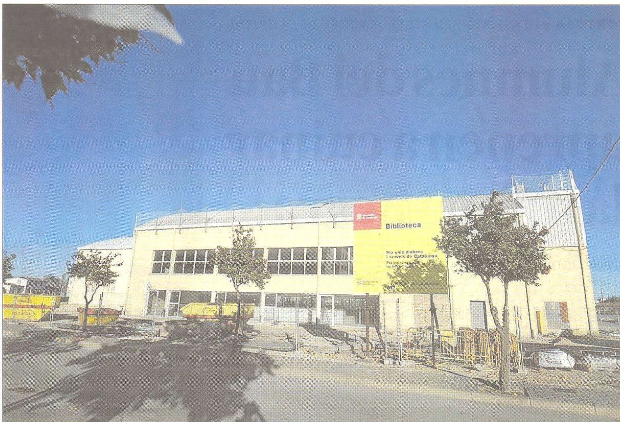
Obres de la nova biblioteca de Deltebre, on la coberta va quedar malmesa. FOTO: JOAN REVILLAS
