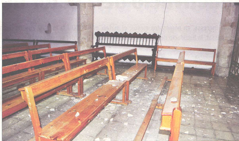
Imatge dels bancs de l'església del convent de Santa Clara plens de la runa caiguda del sostre. / NÚRIA CARO
