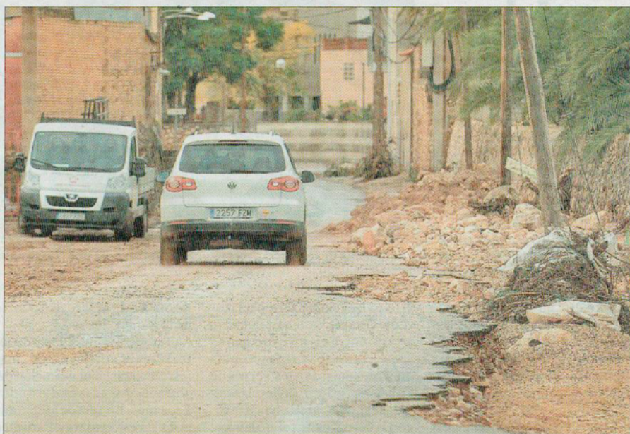
■ Estat del tram final del barranc de la Llet, a Sant Llàtzer, un dia després dels aiguats. FOTO: JOAN REVILLAS
