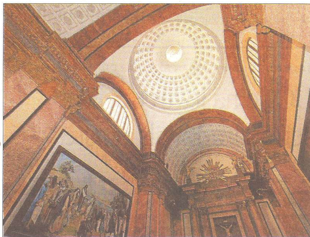
Imatge de l'interior de la capella del Sant Crist, tancada al públic fa uns cinc anys a causa del perill de col·lapse de la cúpula, ahir. FOTO: JOAN REVILLAS
