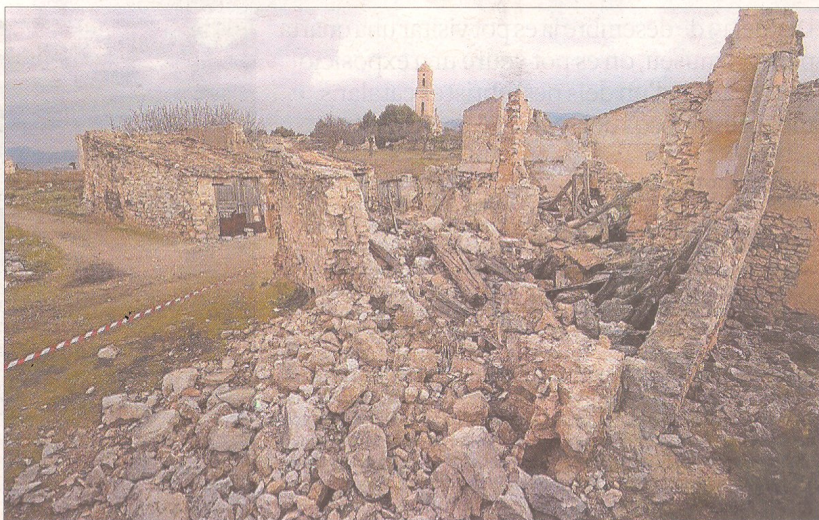
Paret lateral de la casa enrunada que s'ha esfondrat aquestes festes, ahir a la tarda. FOTO: JOAN REVILLAS
