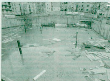
Les obres de l'edifici de les delegacions, cobertes d'aigua. FOTO: J. REVILLAS
