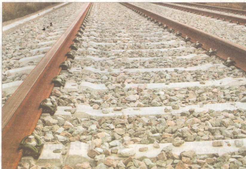
Las traviesas polivalentes PRO1 no admiten un tercer carril. FOTO: PERE FERRÉ
