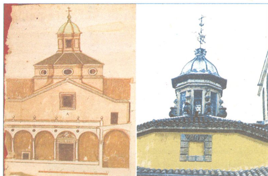
Projecte de la llanterna que necessita neteja i restauració.
