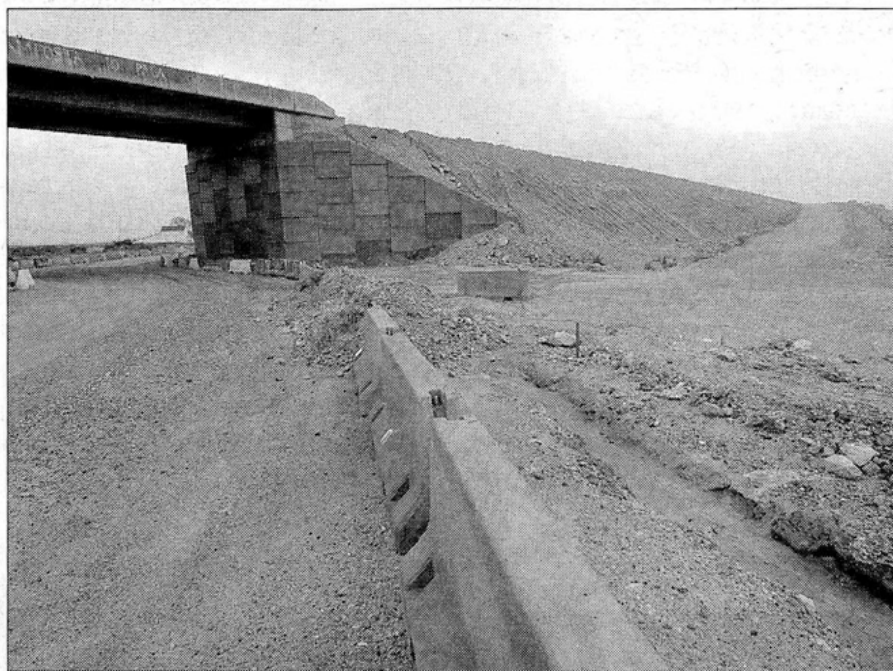
► Imagen del lamentable estado de las obras paralizadas de la variante.
