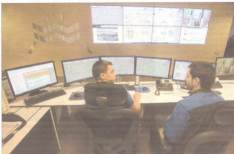
Sala de control de la planta del Consorci d'Aigües a l'Ampolla. FOTO: JOAN REVILLAS
