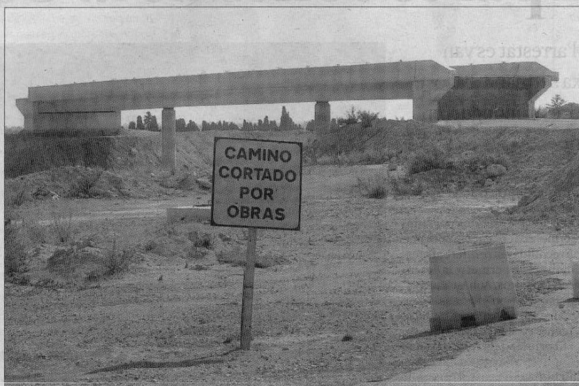
► Estat d'abandonament de les obres de la variant de la N-340 a l'Aldea, ahir al migdia. FOTO: JOAN REVILLAS
