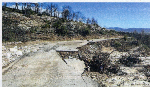
Hay graves afectaciones en caminos y carreteras. FOTO: J. REVILLAS
