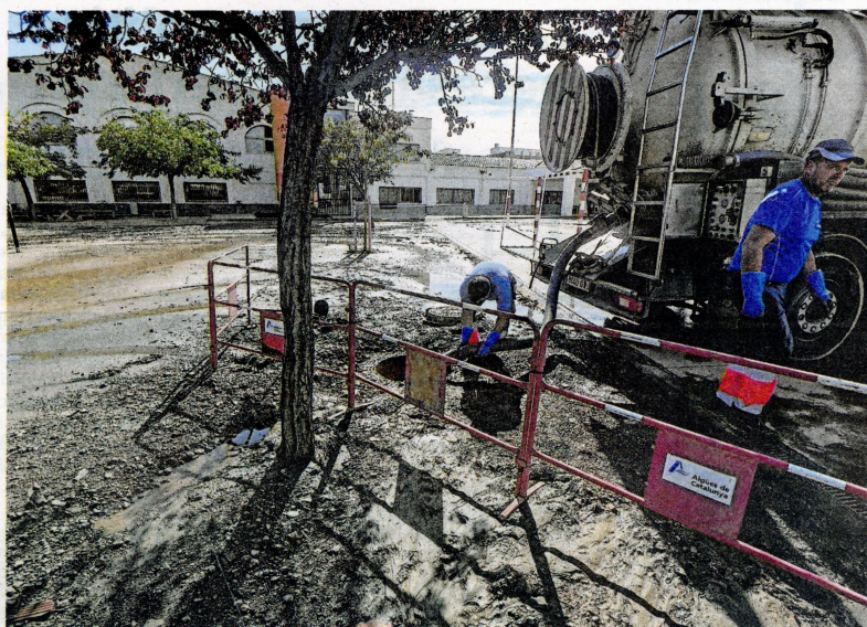
Danys per la DANA Alice, la passada tardor a la Ràpita. FOTO: J. REVILLAS
