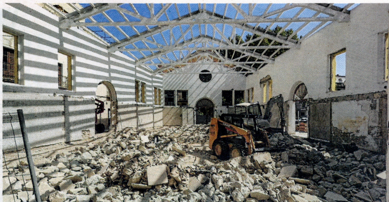
Interior del mercat totalment en runa, aquesta setmana. FOTO: J. REVILLAS
