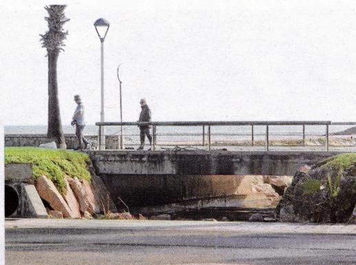
La canalización hacia el mar en el Fondo de Jan no es suficiente y no evacua el agua. FOTO: J. REVILLAS
