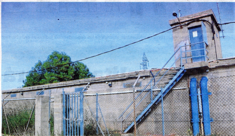
Tuberías y estructuras del depósito municipal de agua potable de Amposta, en Tosses. FOTO: ACN
