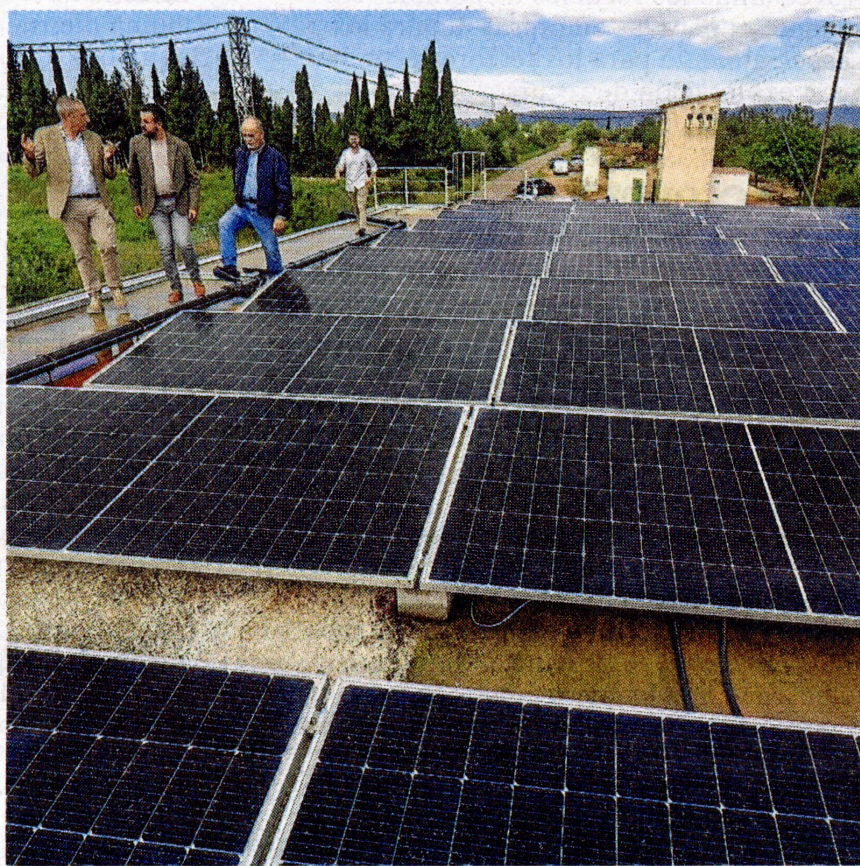
Panells solars instal·lats a la coberta del dipòsit. FOTO: J. REVILLAS
