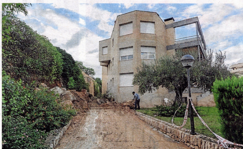
L'edifici afectat pel desprendiment d'un mur de contençió. FOTO: JOAN REVILLAS
