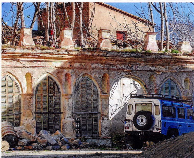
El pavelló es troba en un avançat estat de degradació i podria acabar de caure.
