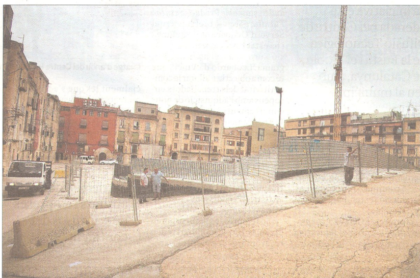
Imatge de l'estat del complex de l'edifici de les delegacions i l'aparcament soterrat. FOTO: JOAN REVILLAS
