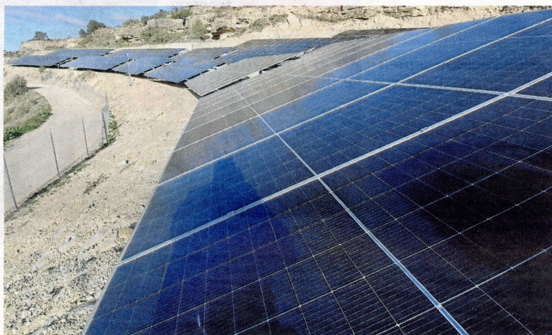
Una planta fotovoltaica a la Terra Alta. FOTO: J. REVILLAS
