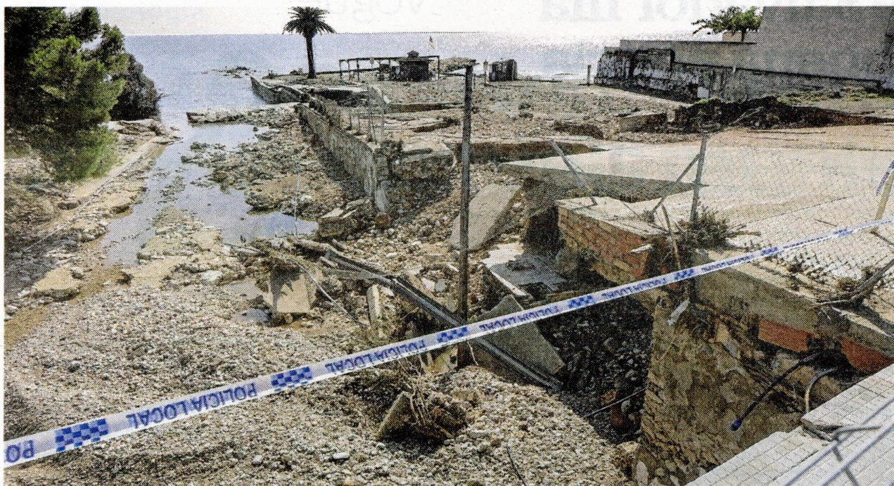
Afectacions al barranc del Suís, a la Ràpita, durant els aiguats de l'octubre passat. FOTO: J. REVILLAS
