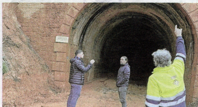
Tècnics inspeccionant el túnel afectat. FOTO: CONSELL COMARCAL TERRA ALTA
