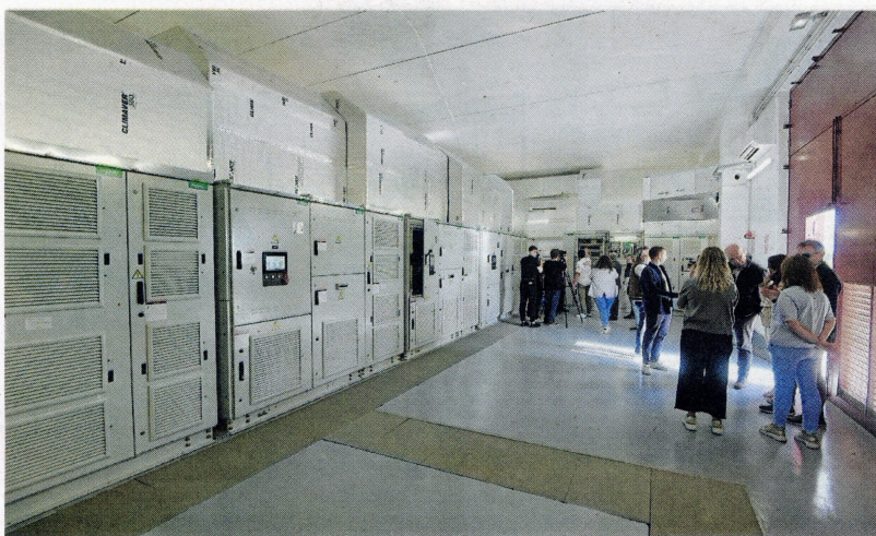
Nous variadors de freqüència a l'estació del CAT de l'Ampolla, recentment instal·lats. FOTO: J. REVILLAS
