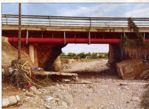
El pont de l'antiga N-340 afectat estructuralment. / DANI CAMACHO
