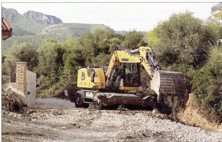
Una excavadora grata el límit d'un dels barrancs afectats per la pertorbació Alice. /CANAL TE
