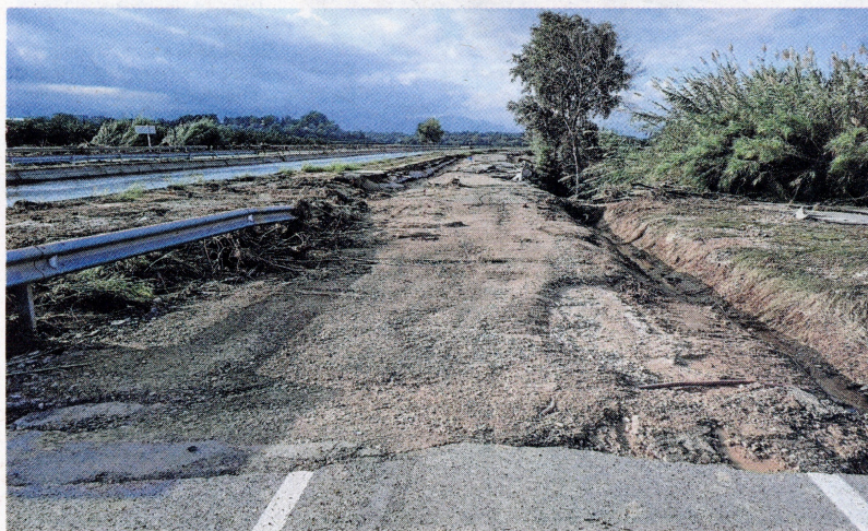
Carretera secundària malmesa vora la C-12 i el canal de la dreta de l'Ebre. FOTO: JOAN REVILLAS
