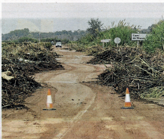
Així va quedar la C-12 a la zona de la carretera de la Carrova en els recents aiguats. FOTO: JOAN REVILLAS
