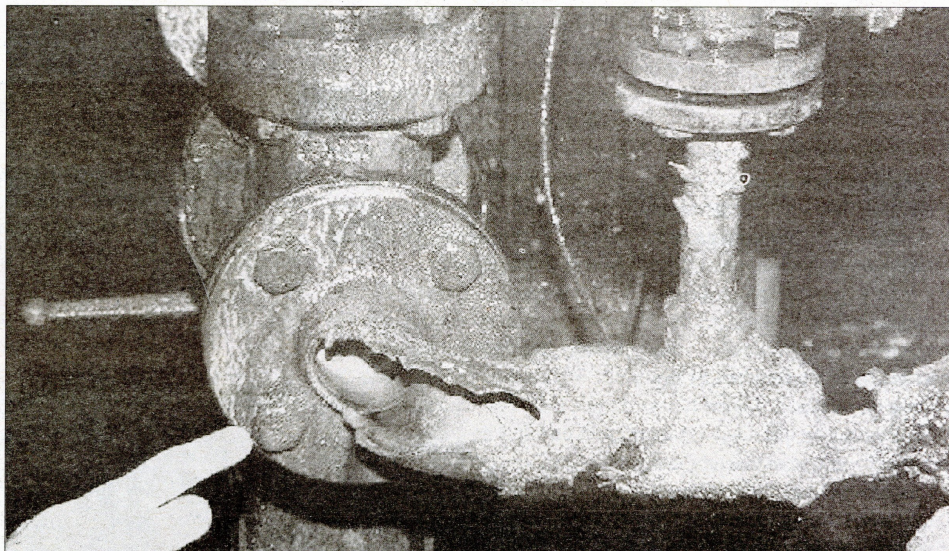
Imatge de la vàlvula on se va produir la fuga / FOTO: LA VEU DE FLIX (1996)
