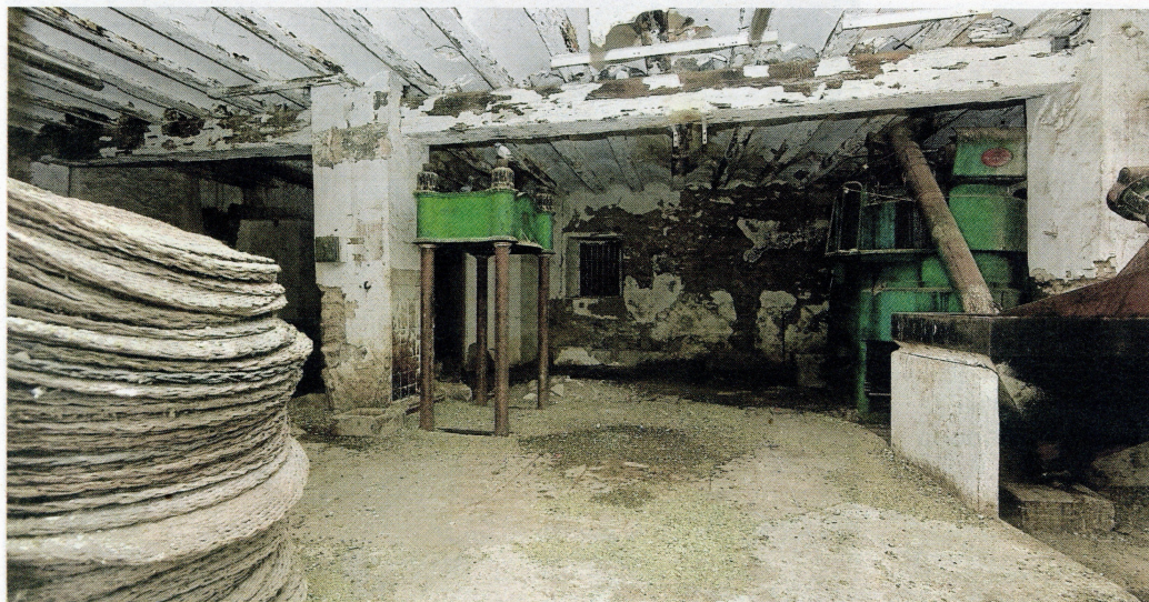
Estat actual de deteriorament de l'interior del molí d'oli. FOTO: JOAN REVILLAS
