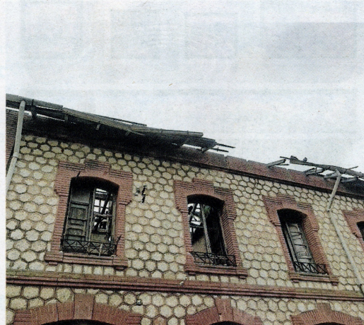
Una part de la teulada de l'edifici es va esfondrar i no s'ha reparat.
