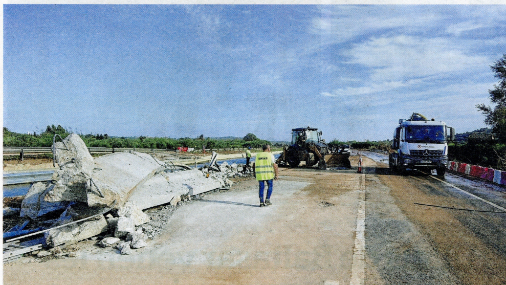
Estat de la carretera C-12 a la confluència amb el barranc de la Galera, entre Amposta i Tortosa. FOTO: JOAN REVILLAS
