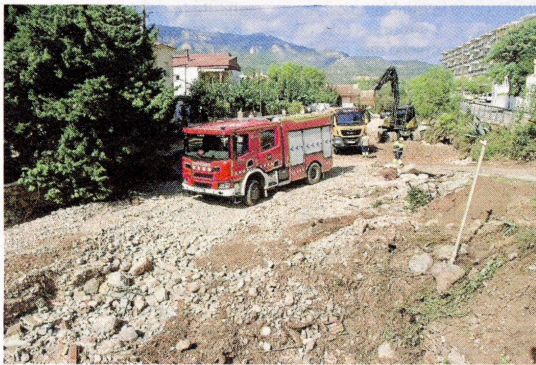
EL barranc del Suís, el martes, gravemente afectado.
