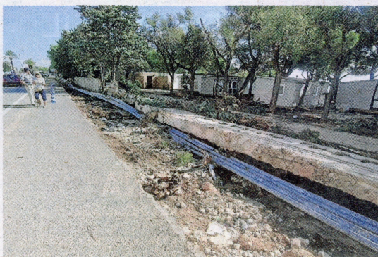
El exterior del càmping Els Alfacs sigue actualmente muy afectado, con el muro destruido. FOTO: J. REVILLAS
