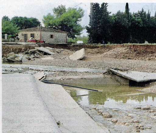
Estat actual del barranc de la Galera, amb alguns punts de pas destrossats. FOTO: JOAN REVILLAS
