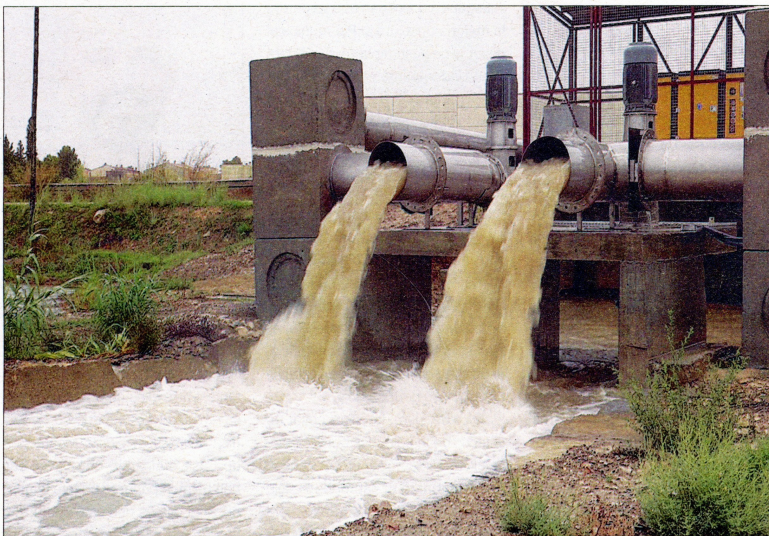
La vintena de carrers inundats a Deltebre es van drenar ràpidament gràcies al desaigüe del Préstamo. / CANAL TE
