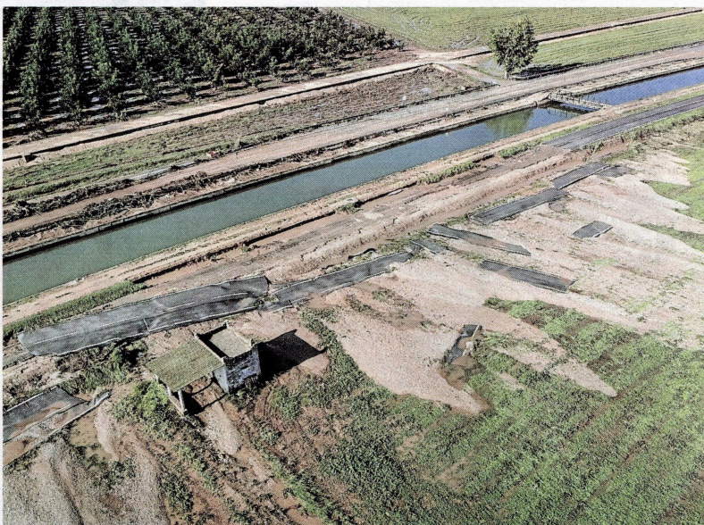
Imágenes aéreas de los destrozos en la carretera TV-3443 entre Amposta y Tortosa. FOTO: ACN
