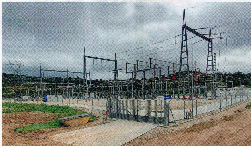
La subestació de Masdenverge, de 400 kW. FOTO: JOAN REVILLAS
