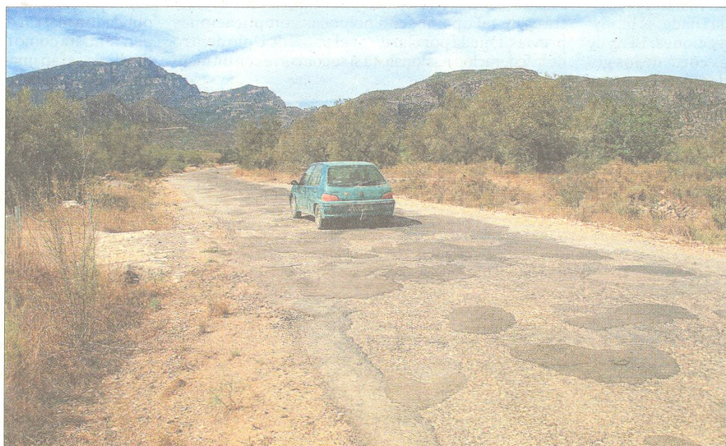
Imatge de l'avançat estat de degradació de l'accés a la carretera del mont Caro, ahir al migdia. FOTO: A. CARALT
