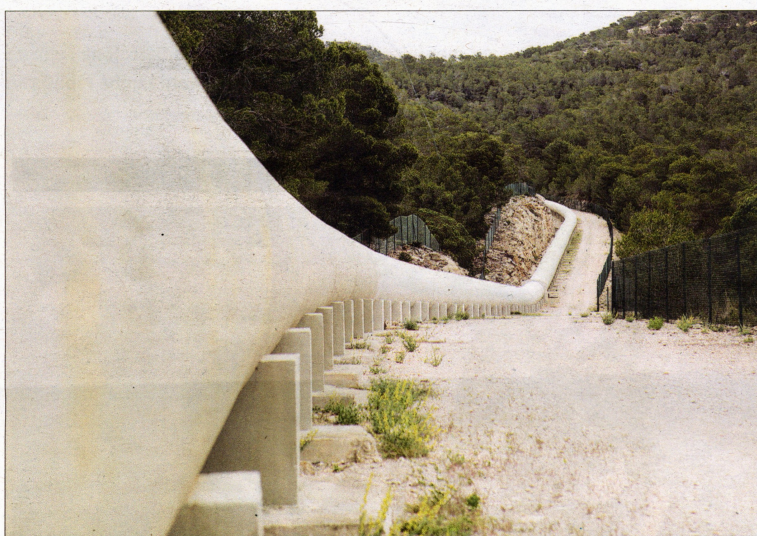
El Consorci d'Aigües de Tarragona subministra aigua potable del riu Ebre a través d'un total de 402 quilòmetres de canonades. La conducció litoral arriba fins al municipi de Cunit, al límit amb la província de Barcelona. / CAT
