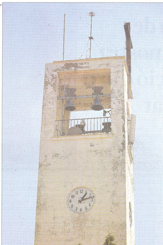
El campanar de l'església de Poble Nou del Delta presenta problemes estructurals i s'ha de rehabilitar. FOTO: JOAN REVILLAS
