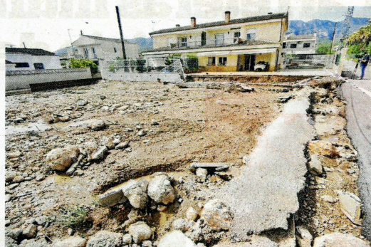
Las construcciones junto a barrancos fueron las más perjudicadas.
