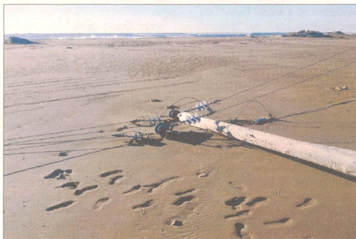
En els últims anys les llevantades han deteriorat força la línia elèctrica.
