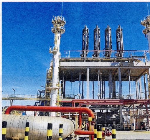
Muelle de amarre de la planta de gas de la compañía Enagás ubicada en el puerto de Barcelona. FOTO: ACN
